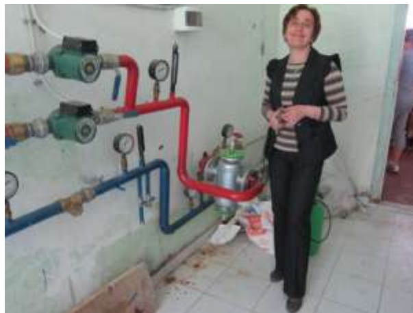
Rektor Svetlana viser fram renseanlegget for vann som førte til at temperaturen inne steg fra 6 grader til 16 grader midtvinters
